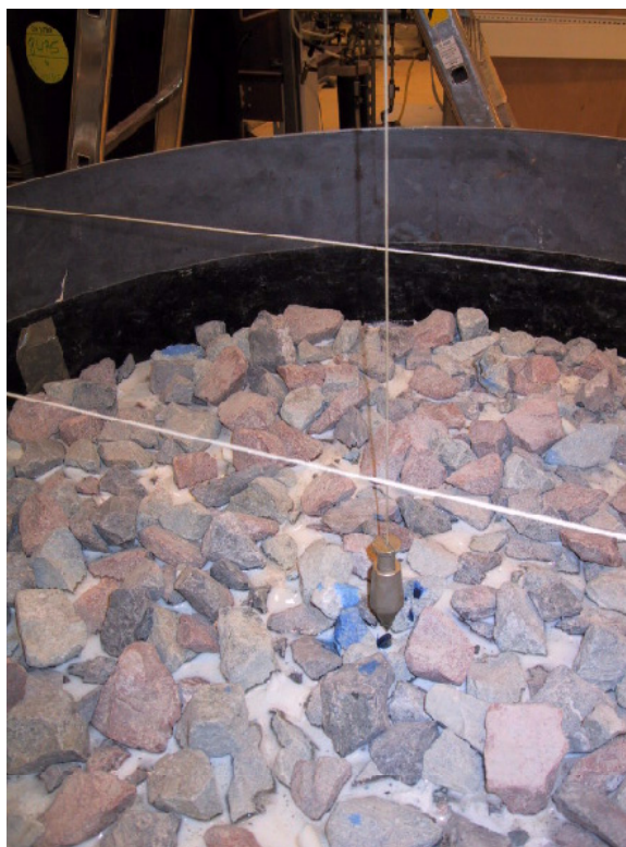
Figure IV-13 : Détail de la mise en place des repères centraux et de direction transversale pour marquage de la plaque moulant la géomembrane
