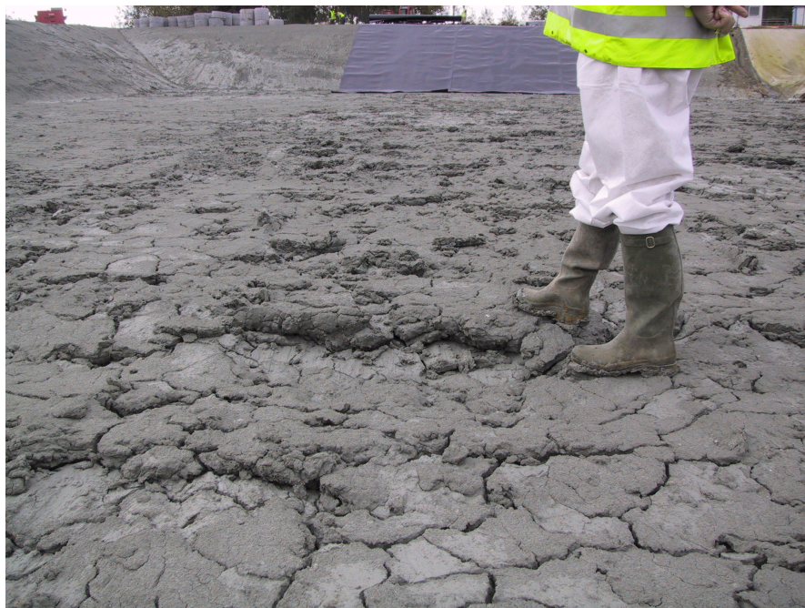
Figure I-10 : Exemple de surface de barrière minérale compactée de façon inappropriée
