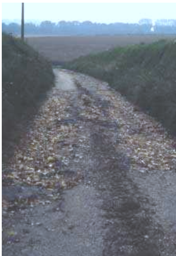
Dégât sur route
