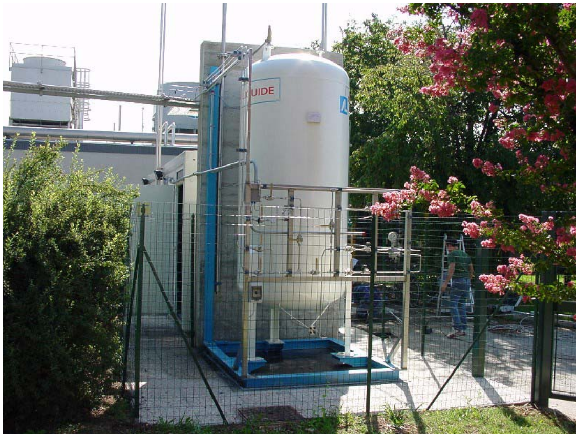
Unité de stockage d'hydrogène 4 m 3 à 10 bar (Air Liquide).
