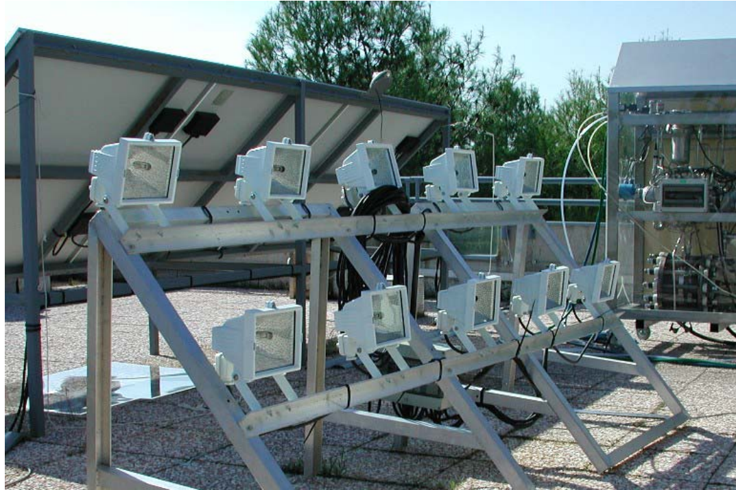
10 lampes de 500 W : puissance variable de 0 à 5 kW.
