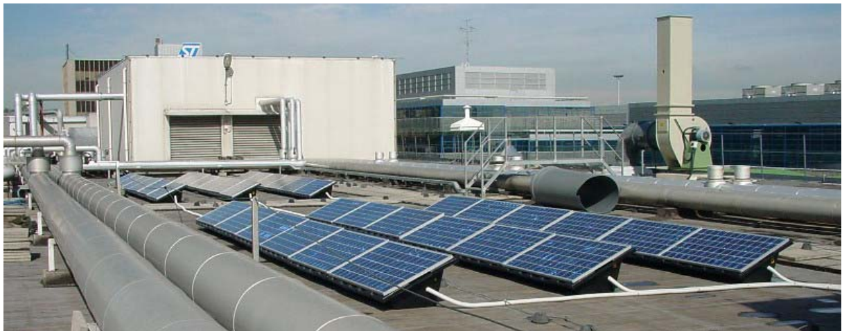
Champ photovoltaïque de 3,6 kW – Inclinaison 30 °.
