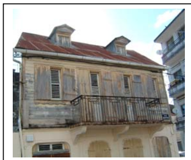
Photo 78- Maison créole dégradée à Fort de France (avril 2004)
