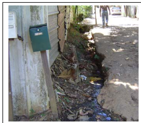
Photo 35 - Caniveau à ciel ouvert au Mont Baduel (octobre 2004)
