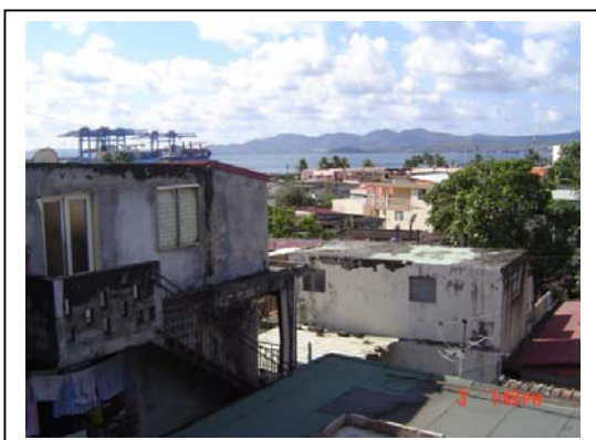
Photo 94 - maisons en dur dégradées à Volga (avril 2004)
