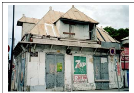
Photo 77 - Maison créole dégradée à Saint-Denis (juin 2003)
