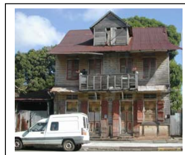
Photo 79 - Maisons créoles dégradées à Cayenne (octobre 2004)
