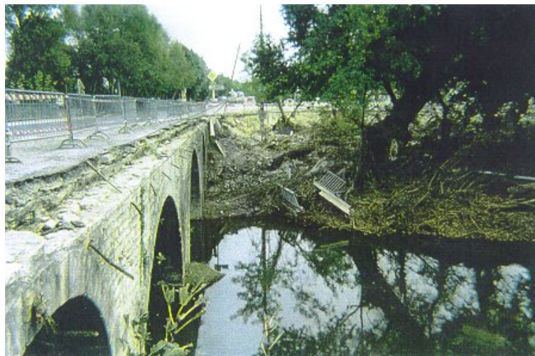
FIG. B.1 – Crue de l'Avène : pont de la Jasse de Bernard, vu depuis l'aval.
