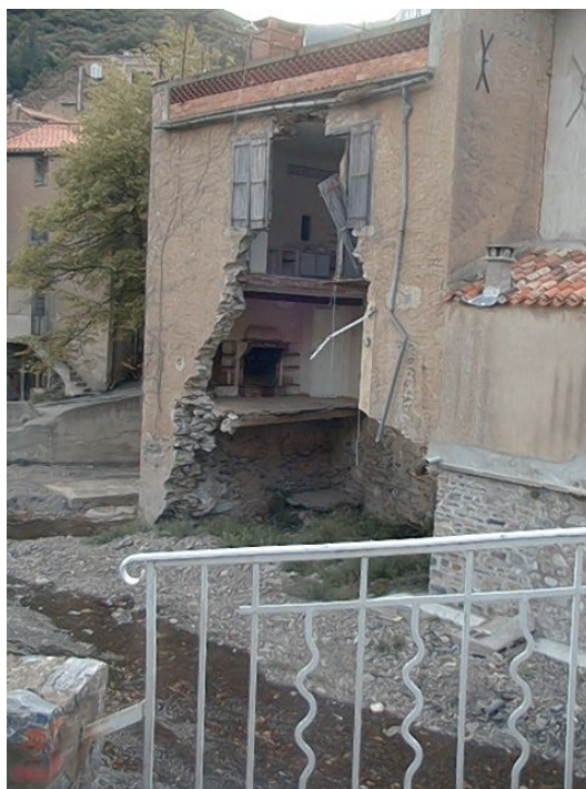
FIG. B.16 – Crue de la Clamoux : maison effondrée à la confluence entre le ruisseau de Ganganel et la Clamoux à Cabrespine
