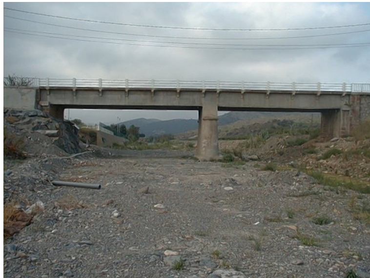
FIG. B.10 – Crue du Verdoble : pont de la D.611 sur le petit Verdoble à Tuchan, vu de l'aval.
