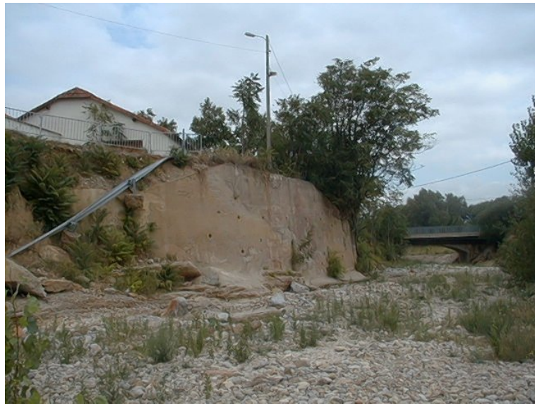
FIG. B.6 – Crue du Verdoble : ruisseau de Coume en amont immédiat de sa confluence avec le Verdoble à Paziols.
