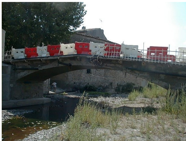
FIG. B.17 – Crue de la Clamoux : vieux pont de Villeneuve-en-Minervois vu depuis l'amont.
