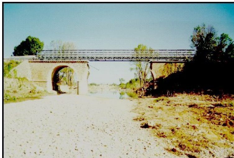
FIG. B.4 – Crue de la Nielle : pont Charles à l'aval du bassin versant de la Nielle, vu de l'amont.
