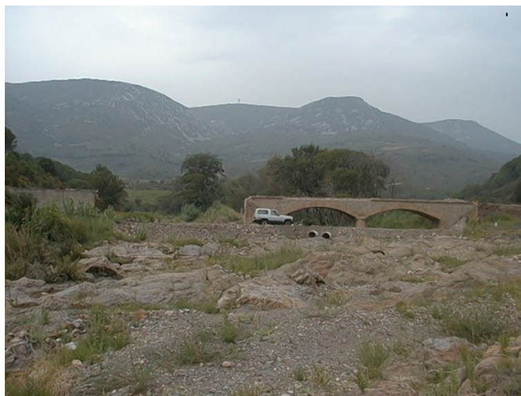
FIG. B.9 – Crue du Verdoble : pont de la D.39 sur le petit Verdoble en amont immédiat de Tuchan, vu de l'aval.
