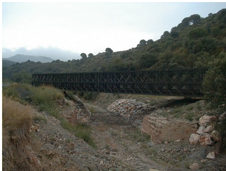
FIG. B.8 – Crue du Verdoble : pont amont sur la Donneuve vu de l'aval.
