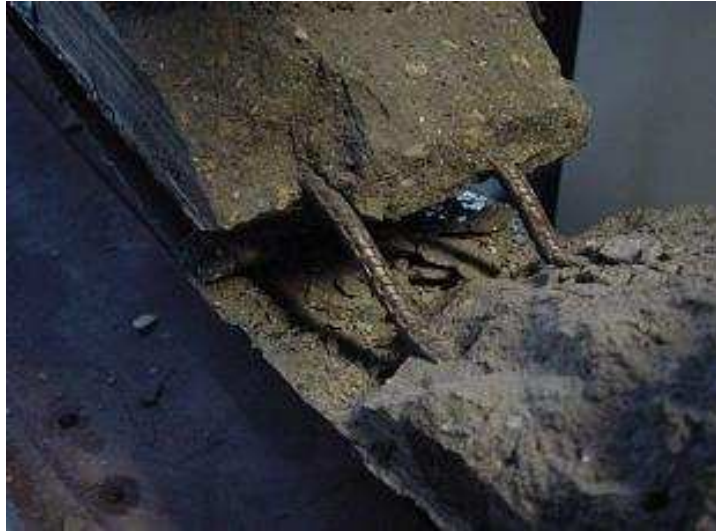
FIG. 9.16. Mode de ruine de la poutre 1 de (Limam et al., 2003a)
