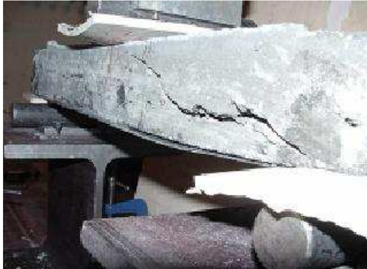
FIG. 9.22. Mode de ruine de la poutre 4 de (Limam et al., 2003a)
