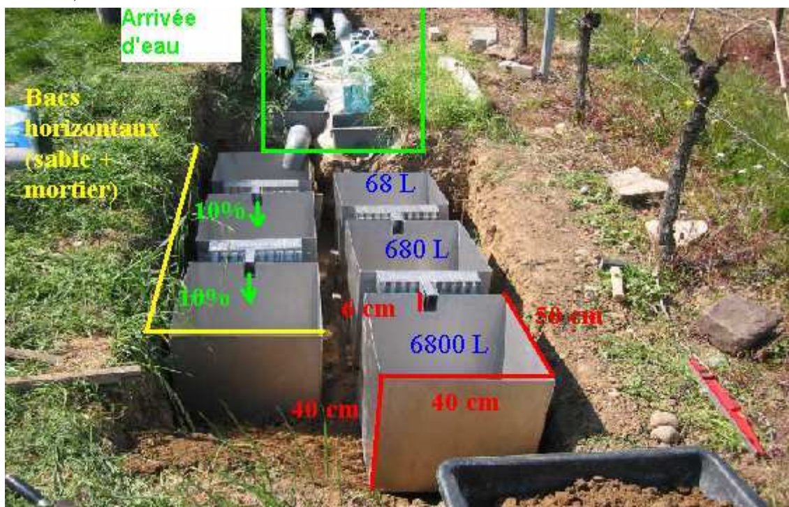
Figure 3- 7 Bacs répartiteurs de volume du Protocole Réseau National Transfert installés à l'exutoire des deux placettes expérimentales du bassin versant de Rouffach (Haut-Rhin, France).
