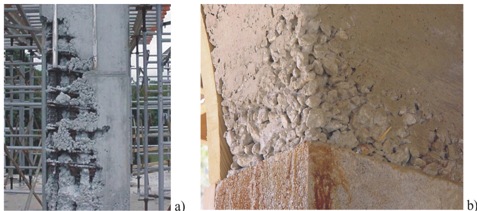
Figure 2.3: Exemples de mauvaises mises en œuvres du béton. a) Mauvais remplissage d'une colonne ; b) Ségrégation des granulats
