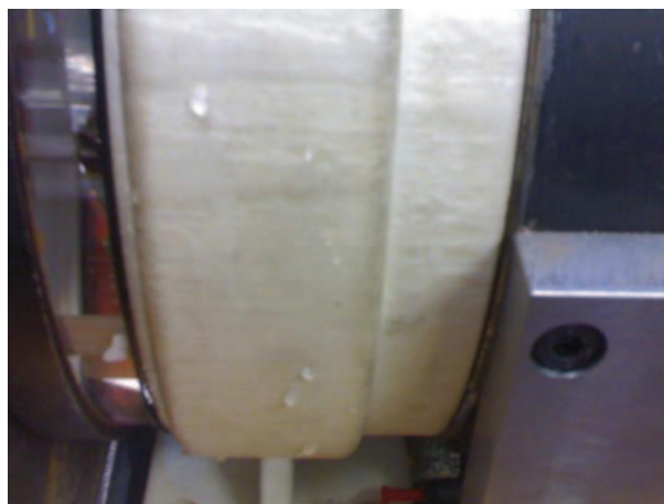
Figure 5-8 : Visualisation du défaut d'étanchéité du corps de pompe
