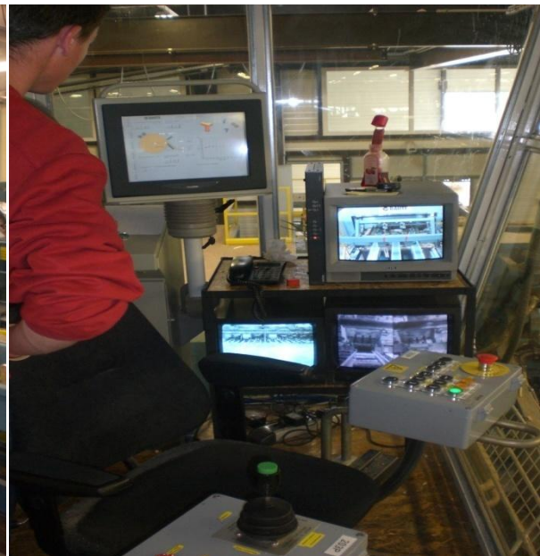
Figure II.24- Cabine de commande et de contrôle de la ligne de déroulage utilisée.
