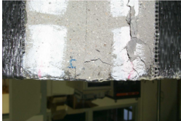
Figure II-45 Délaminage du béton d'enrobage (poutre n°23, HA8)
