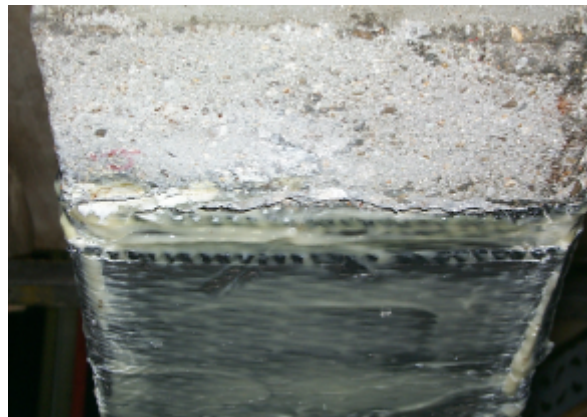
Figure II-46 Décollement à l'extrémité du TFC en surface tendue (vue dessous – poutre n°23, HA8)
