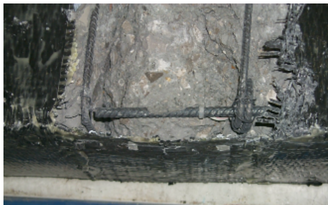
Figure II-44 Rupture en fatigue d'une armature tendue au droit d'un cadre (poutre n°23, HA8)
