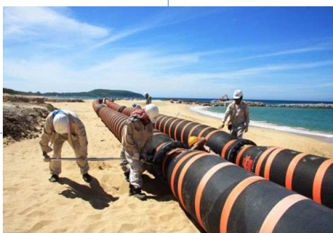
Transfert des hydrocarbures
