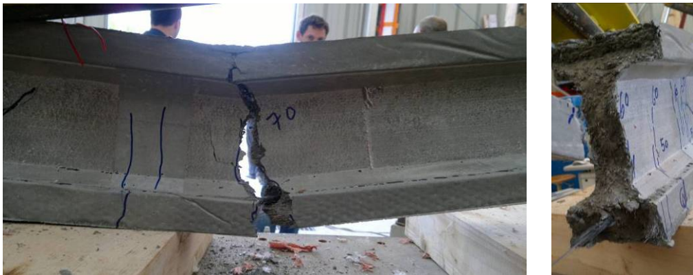
Fig.4.22. Rupture de la poutre PP-JCU12 en flexion
