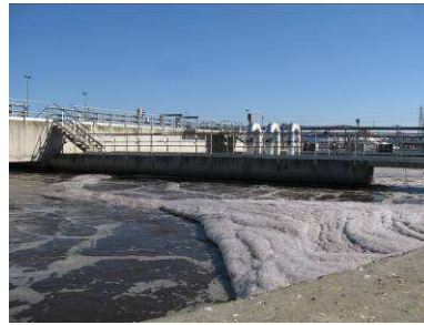
(b) Bassin d'aération
