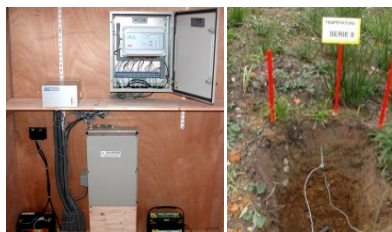
Relevé en continu de la température et de l'humidité du sol
