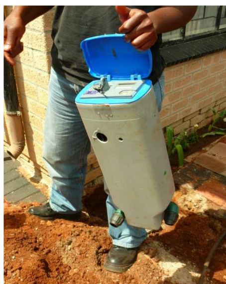
Illustration 12 – Installation d'un compteur à prépaiement © JW
