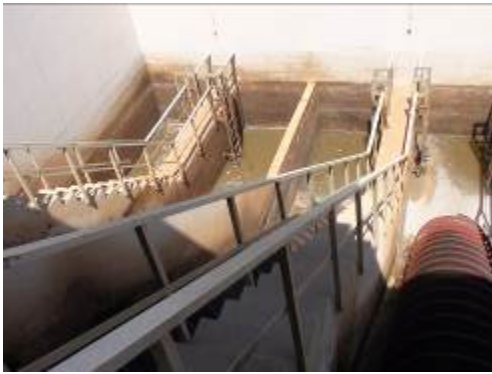
Vis de relevage des eaux usées en entrée de station
