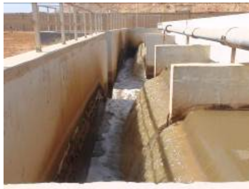
Eau traitée avant rejet en mer
