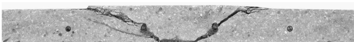
Fig. 65 : Fissuration à plusieurs niveaux de charge et fissures internes de la dalle B3-03.
