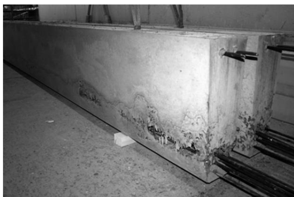
Figure 7 : Défauts d'enrobage poutres AV-5/6
