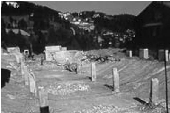
Fig. 5 : Poinçonnement d'une dalle de parking.
