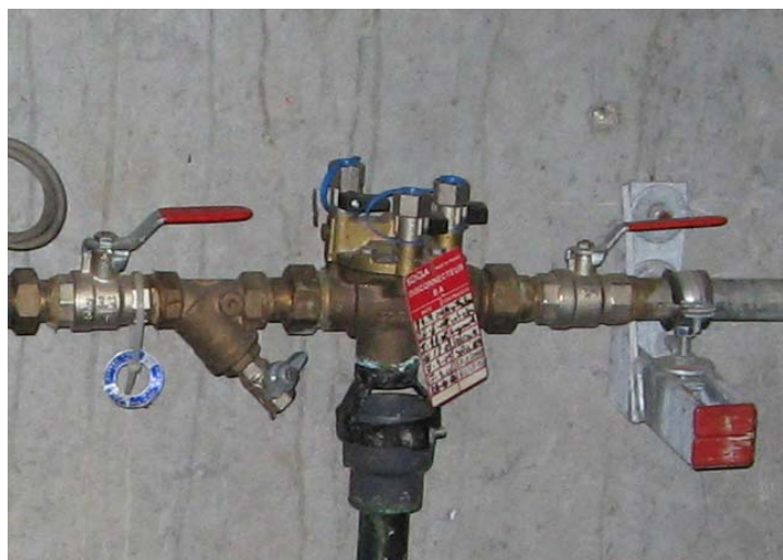
Figure 0-3 : Disconnecteur de type BA installé sur le réseau intérieur d'eau potable.
