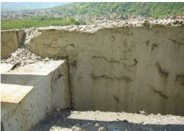
Figure 1.28 Muret en béton dégradé par gel interne
