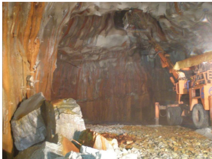
FIGURE IV.30 – Photo de la zone où a eu lieu la chute de blocs
