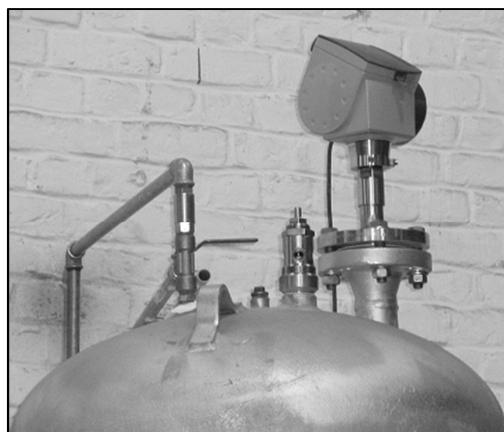
Figure 23 : vue du haut du réservoir d'accumulation avec conduites d'alimentation d'air comprimé, soupape de sureté et capteur de hauteur d'eau
