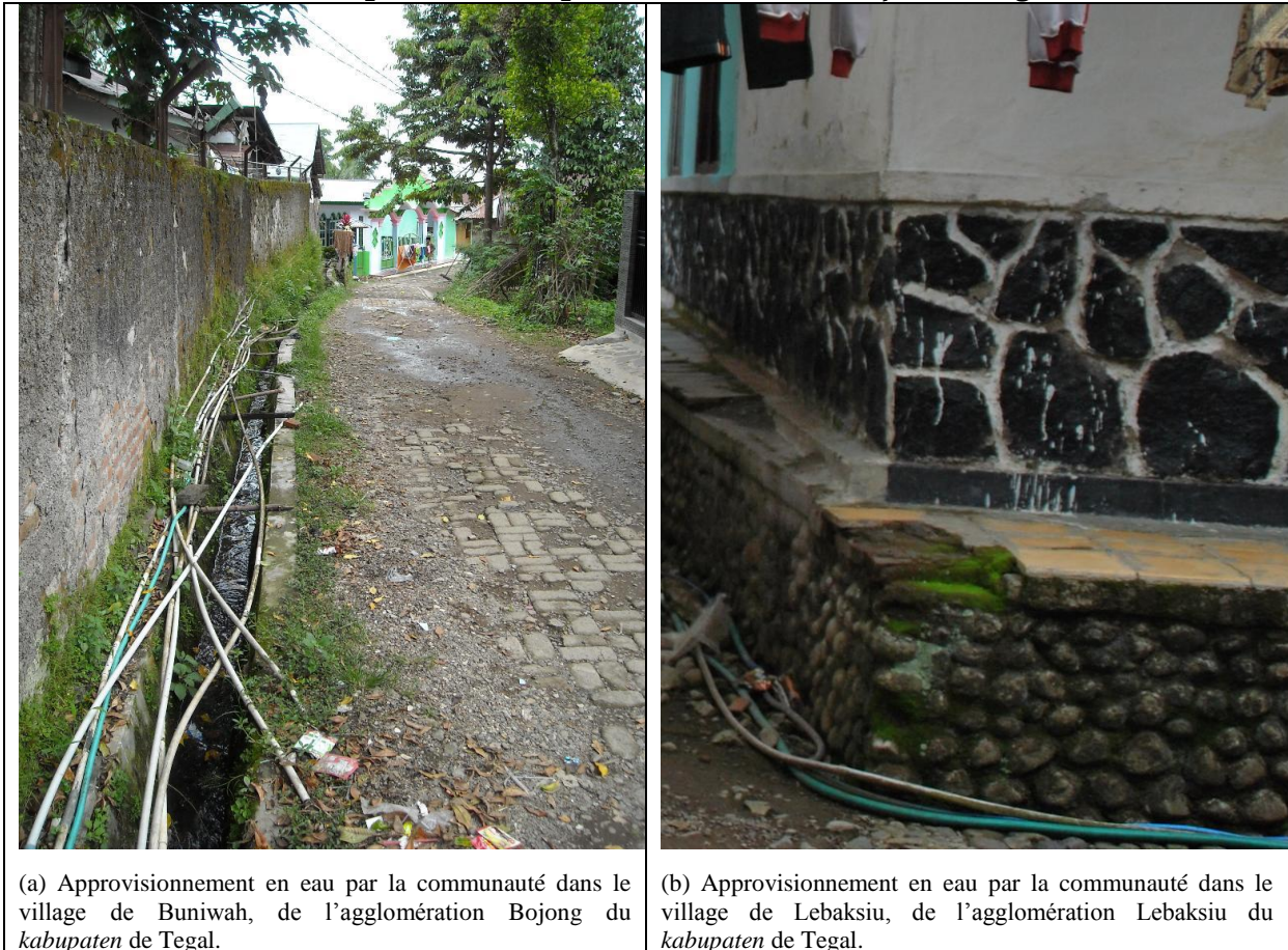
Figure 6.1 Des illustrations du système de tuyaux en plastique utilisé par les communautés pour développer leur propre système d'approvisionnement en eau dans certains quartiers des petites villes du kabupaten Tegal, 2010
