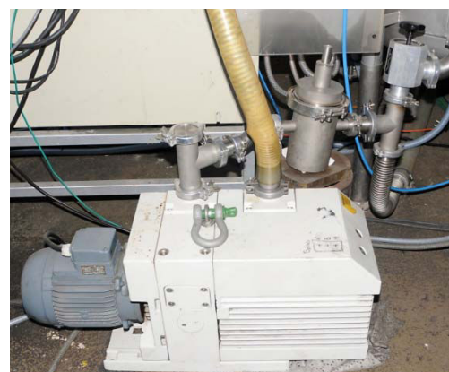
Figure 18: pompe à palettes avec piège à vapeur d'eau fonctionnant à l'azote liquide.
