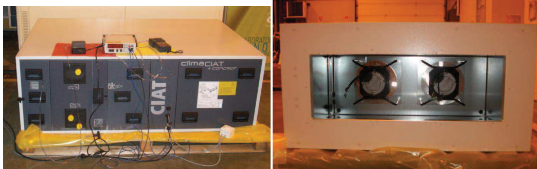
Figure 150. Vues d'ensemble de l'échangeur en essai et des groupes motoventilateurs
