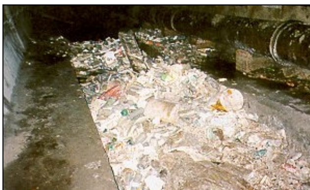
Figure VII-4 - Exemple de collecteur envahi par des "flottants"
